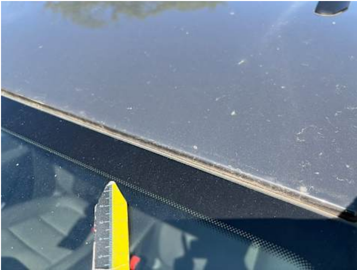
Dach (Lackschaden, Steinschlag)
