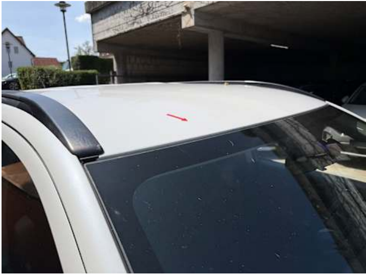
Dach (Steinschlag, Rost)
