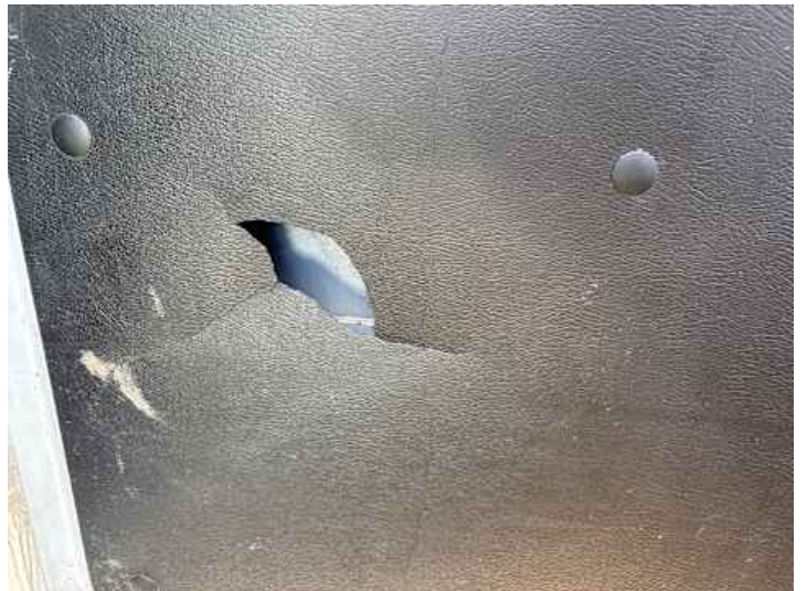
Innenraum (Diverse Schäden, Riss/Bruch)
