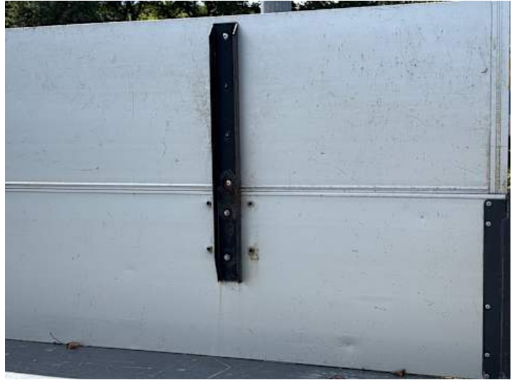
Innenraum (Anderer Schaden, Diverse Schäden): Korrosion
