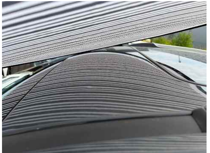
Dach (Anderer Schaden): Hagelschaden
