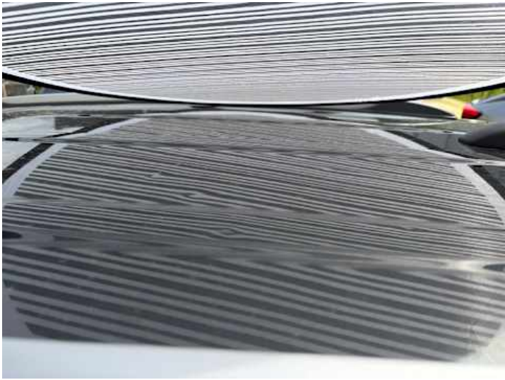
Dach (Anderer Schaden): Hagelschaden
