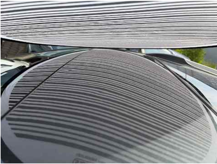
Dach (Anderer Schaden): Hagelschaden
