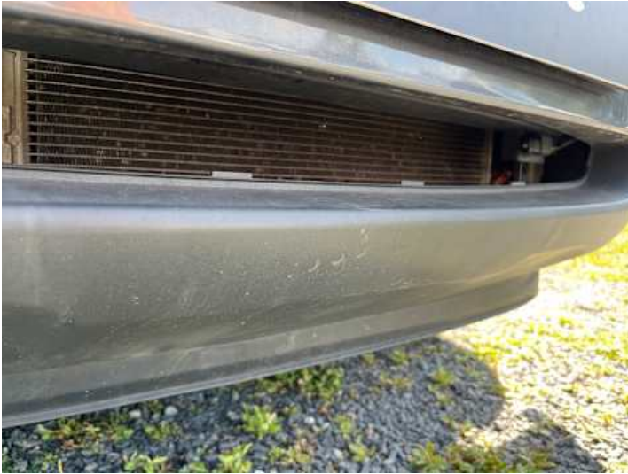
Stoßstange vorne (Verformung)
