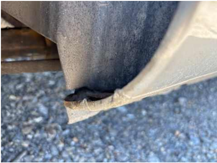
Schweller rechts (Rost)
