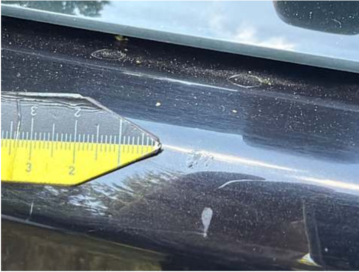
Heckklappe (Rost, Kratzer)
