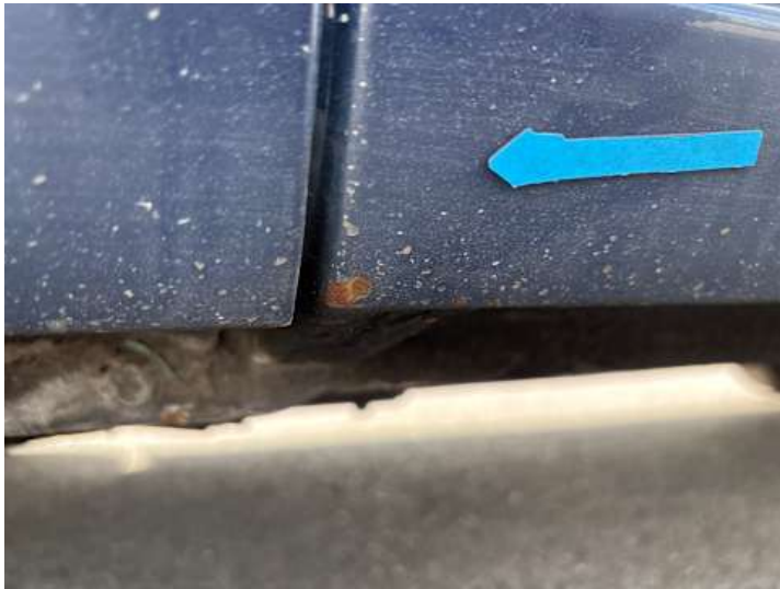
Schweller links (Rost)
