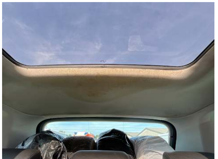
Innenraum (Verschmutzung, Wassereintritt)
