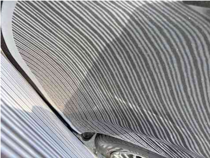
Seitenteil hinten links (Unsachgemäß instand gesetzt)
