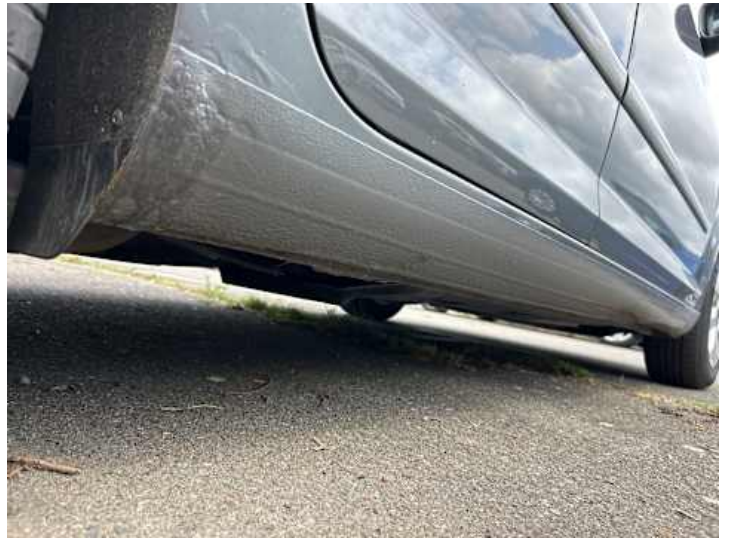
Schweller rechts (Rost, Verformung)
