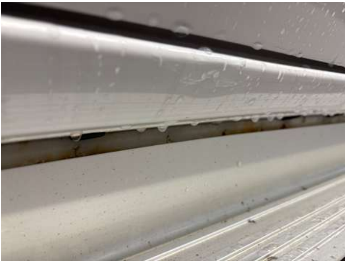
Schweller rechts (Rost)
