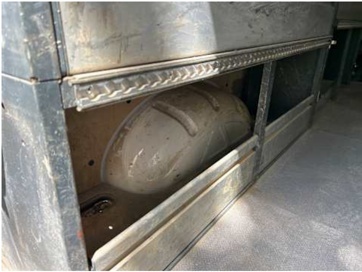
Innenraum (Verschleiß, Diverse Schäden)
