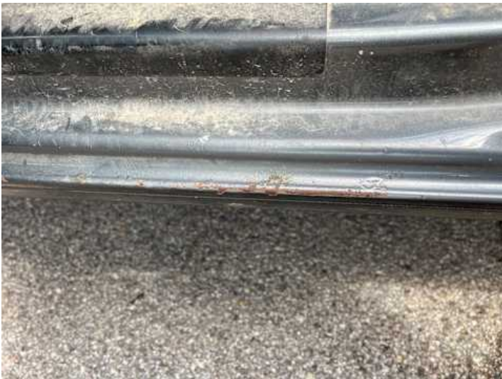
Schweller links (Rost)
