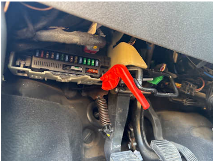
Innenraum (Verschmutzung, Diverse Schäden, Nicht vorhanden)
