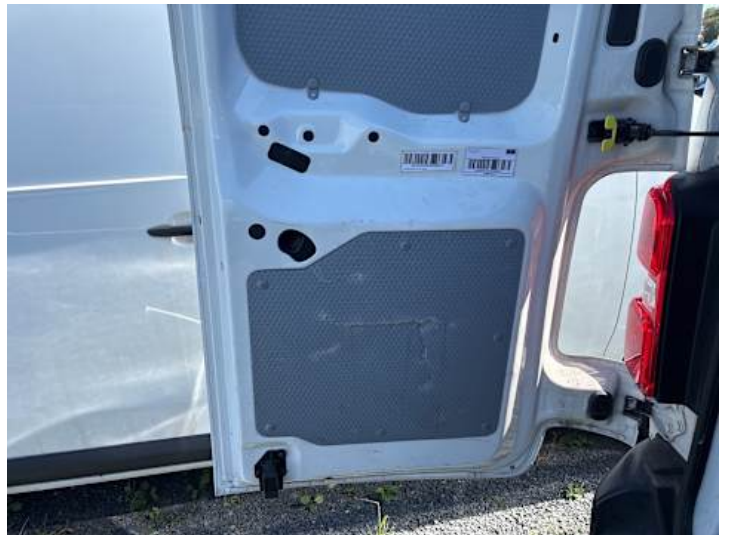
Innenraum (Diverse Schäden)
