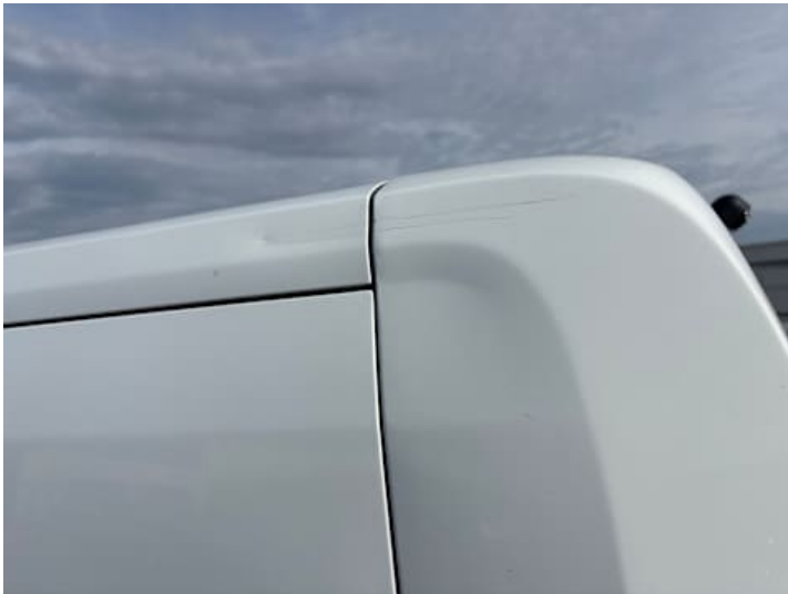
Dach (Kratzer, Verformung)
