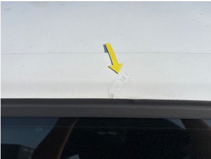
Dach (Unsachgemäß instand gesetzt)
