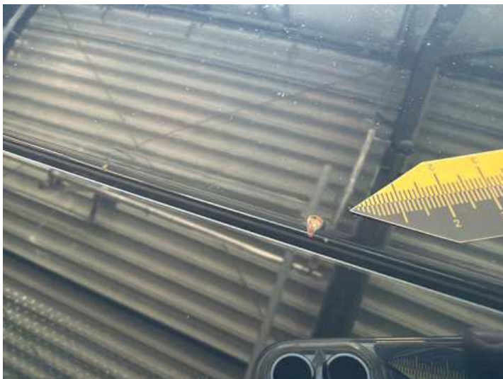
Dach (Steinschlag, Rost)
