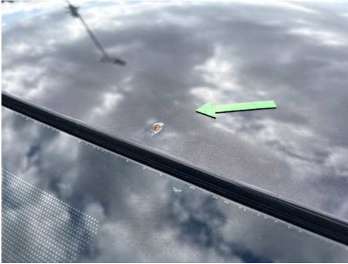
Dach (Lackschaden, Rost)
