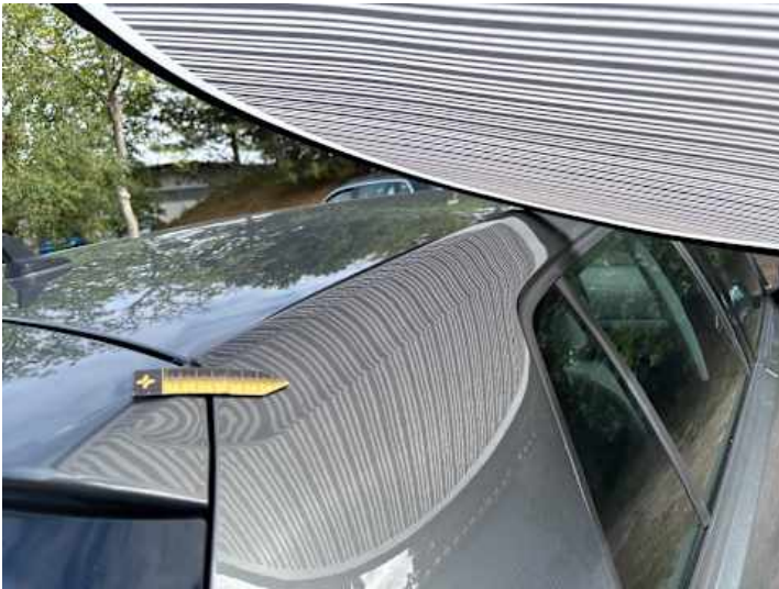
Dach (Unsachgemäß instand gesetzt)
