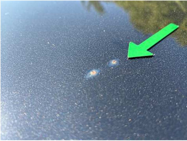
Dach (Rost, Steinschlag)
