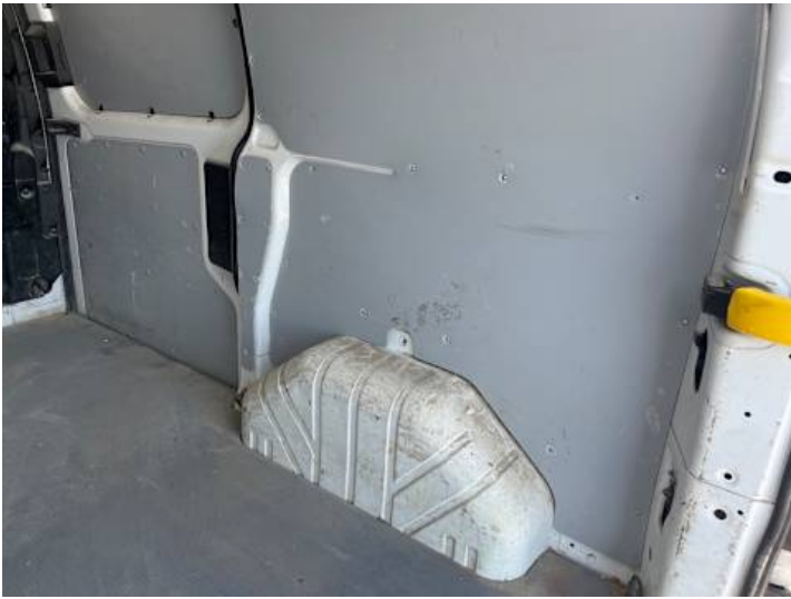
Innenraum (Diverse Schäden)
