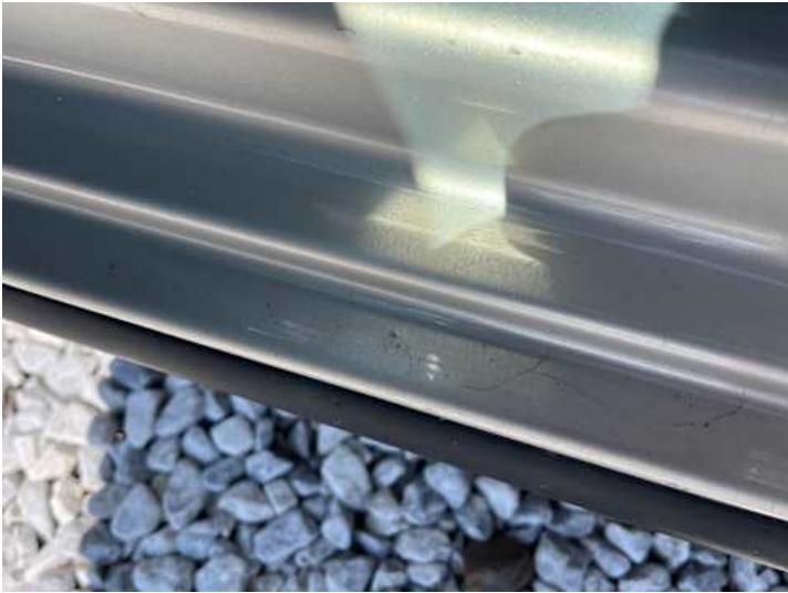
Schweller links (Rost)
