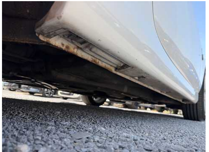
Schweller rechts (Rost)
