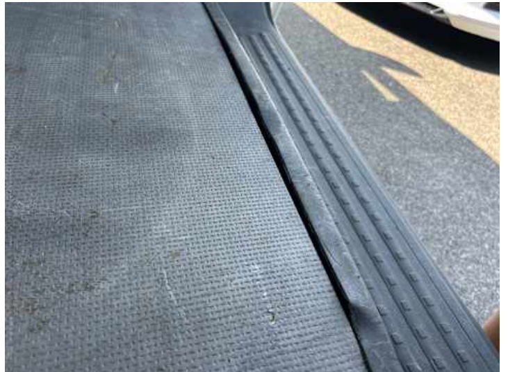
Innenraum (Diverse Schäden)
