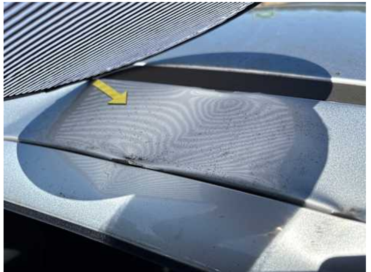
Dach (Verformung, Delle, Riss/Bruch, Lackschaden)
