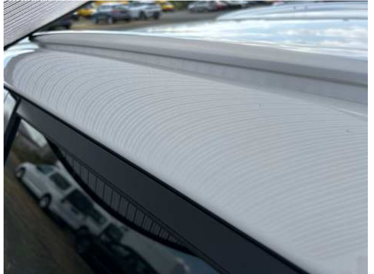
Dach (Unsachgemäß instand gesetzt)
