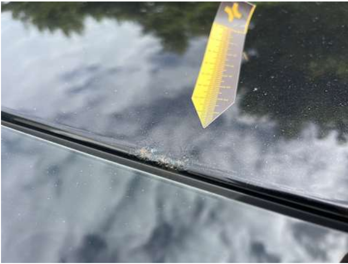
Dach (Lackschaden, Rost)
