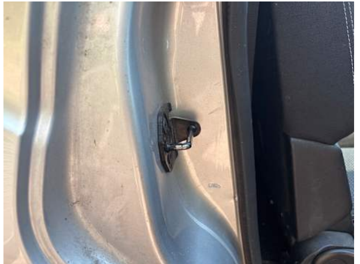
Türe hinten rechts (Delle)
