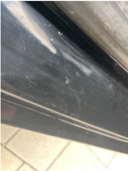
Schweller rechts (Rost)
