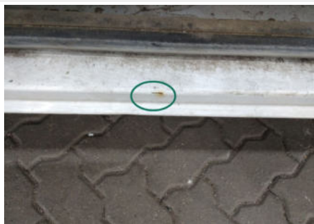
Türeinstieg / Rechts / Rost
