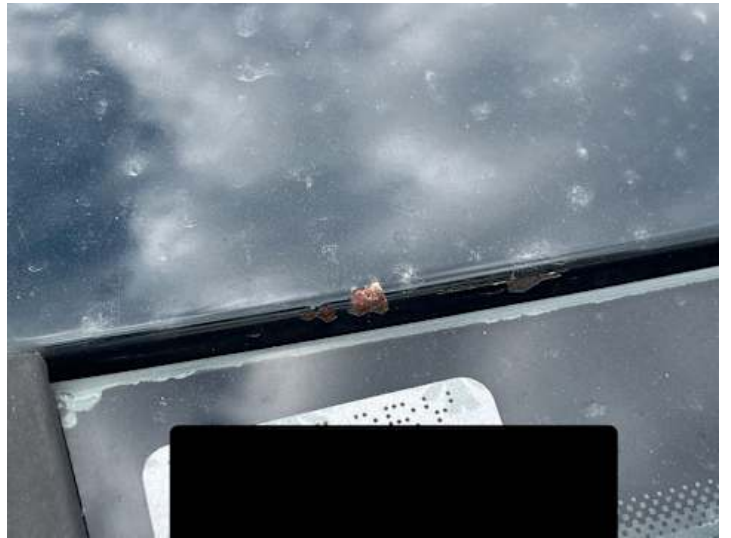
Dach (Steinschlag, Rost)
