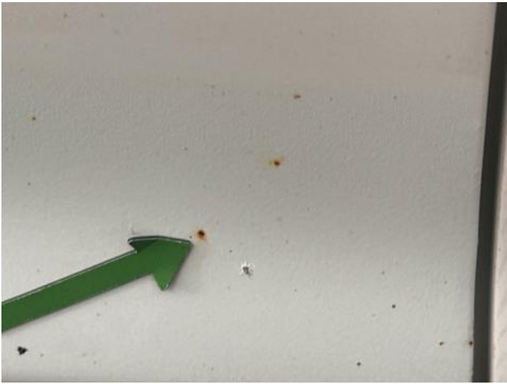
Fahrtür (Delle, Rost)
