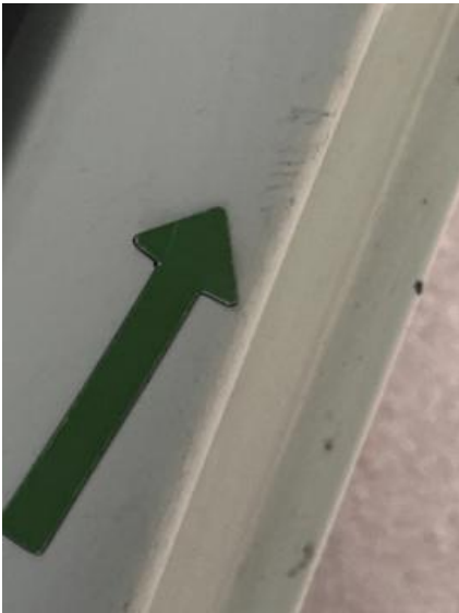
Schweller rechts (Rost)
