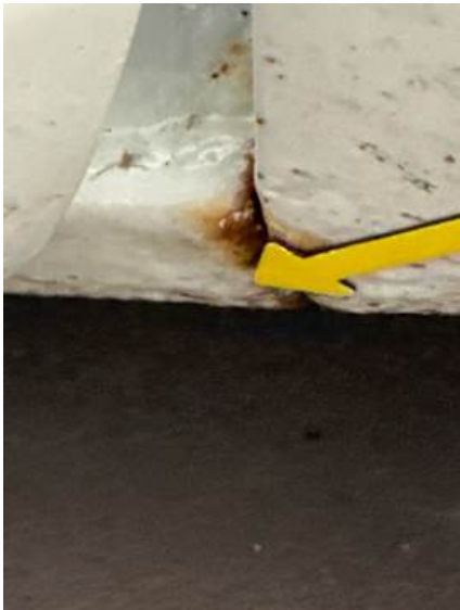
Schweller rechts (Rost)
