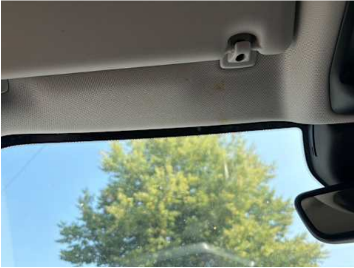
Innenraum (Diverse Schäden, Kratzer, Verschmutzung)
