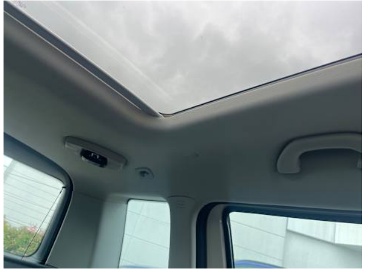
Innenraum (Diverse Schäden)
