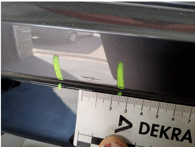
Stoßfänger hinten Lackierung, verschrammt, smart repair (DEKRA)
