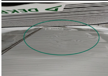
Dach / Vorne / Delle
