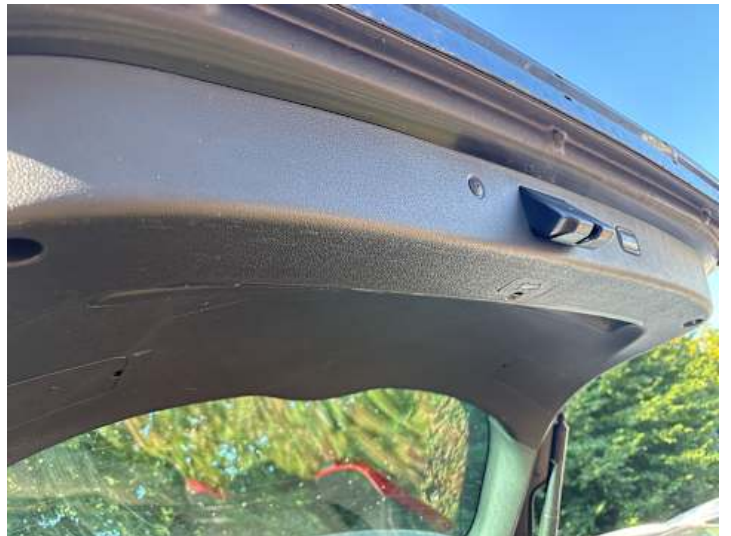
Innenraum (Verschleiß, Kratzer)
