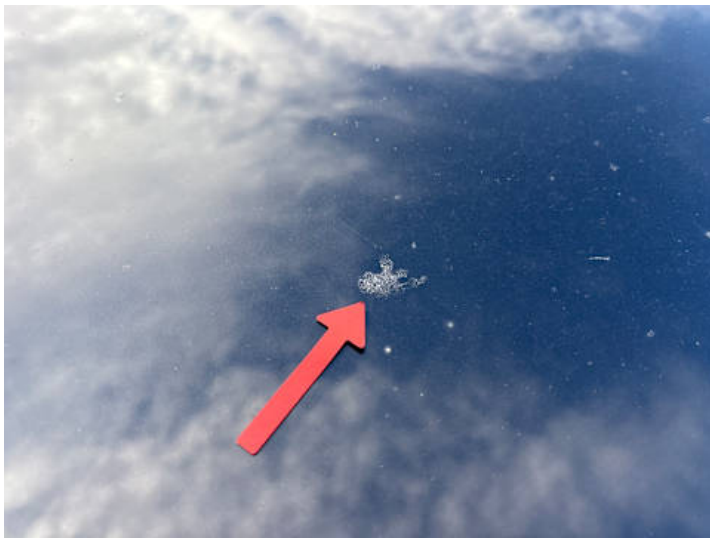
Dach (Lackschaden, Rost)
