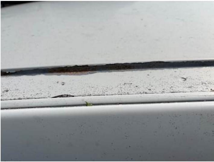
Dach (Lackschaden, Rost)
