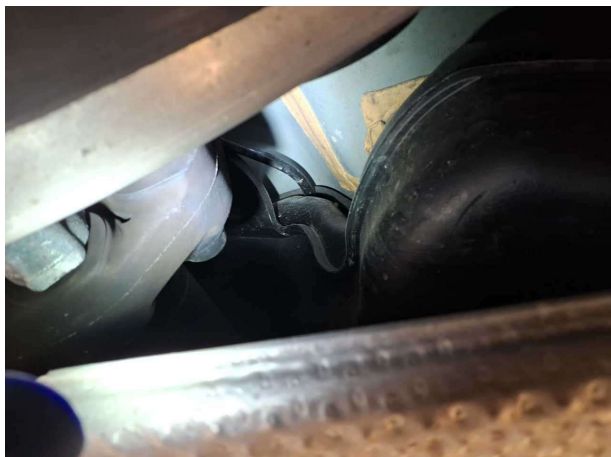
Beschädigung 8: Sonstiges: Sonstiges (Hardyscheibe) - porös / rissig - erneuern
