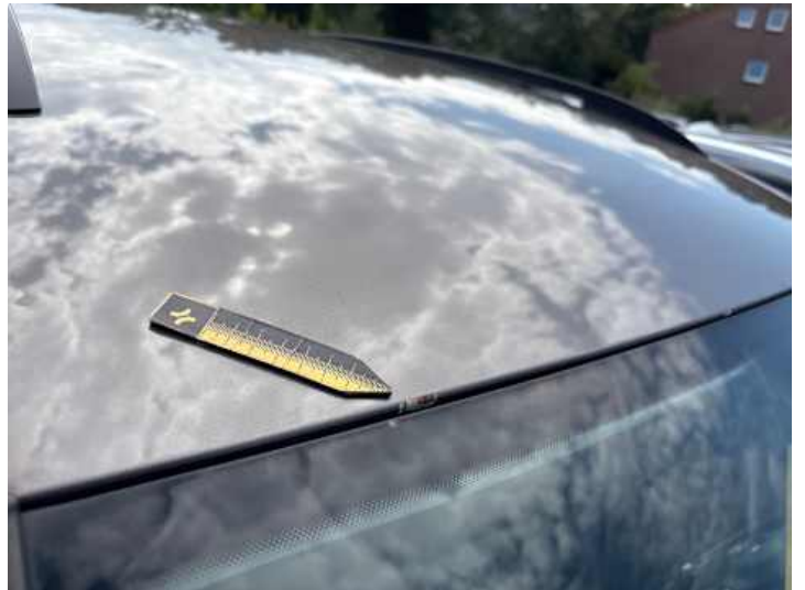
Dach (Rost, Steinschlag)
