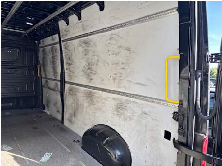
Innenraum (Kratzer, Diverse Schäden)
