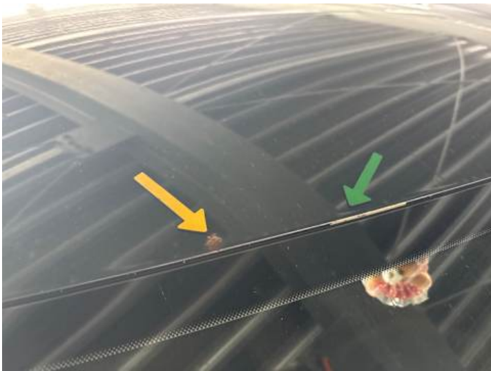
Dach (Lackschaden, Rost)
