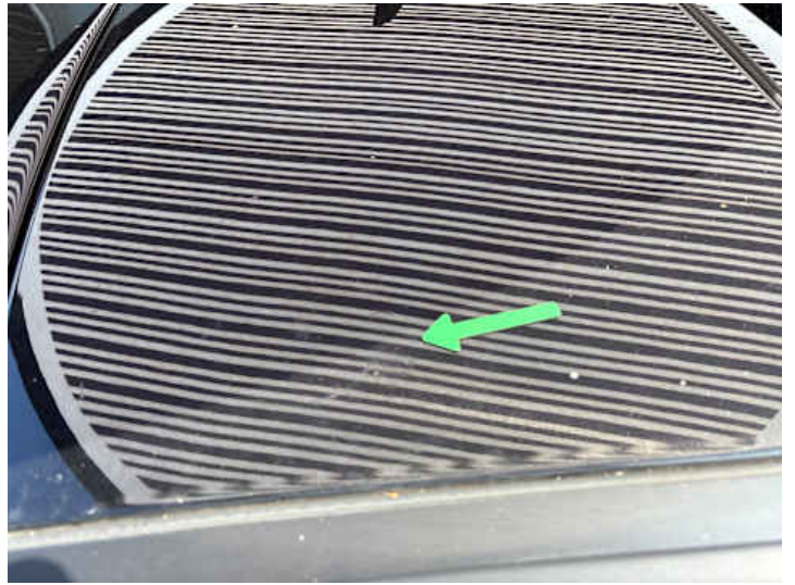
Dach (Lackschaden, Unsachgemäß instand gesetzt)
