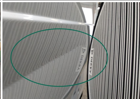
Seitenwand / Unten Links / Delle
