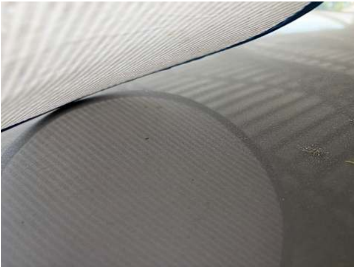
Dach (Delle, Anderer Schaden): Hagelschaden
