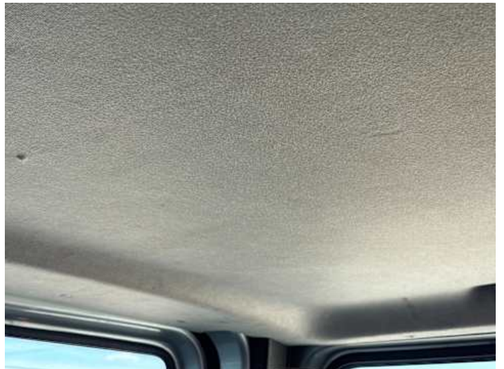
Innenraum (Verschmutzung, Verschleiß)
