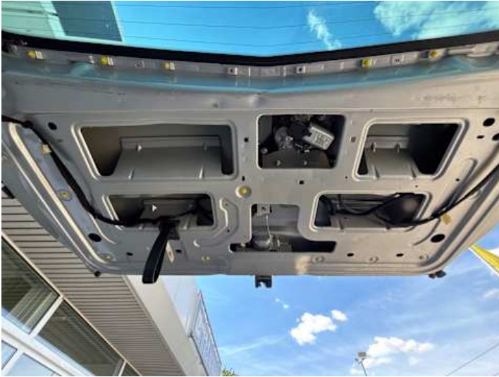
Innenraum (Anderer Schaden): Verkleidung fehlt
