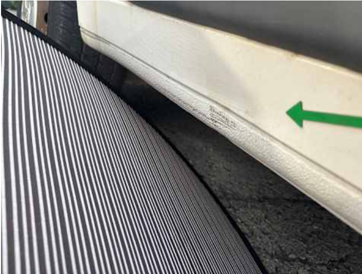
Seitenteil hinten rechts (Verformung)
